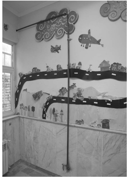
لوله کشی گاز در مرکز
