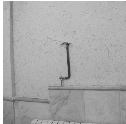
لوله کشی گاز در مرکز
